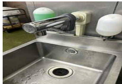
1階作業場 (センサー)
