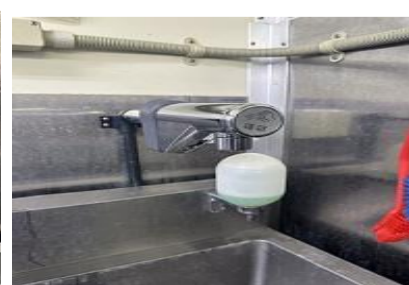
2階作業場 (センサー)
