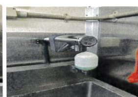
2階作業場 (センサー)
