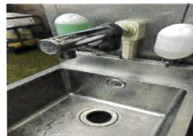
1階作業場 (センサー)
